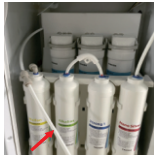
13. Gắn thêm 1 đoạn ống nhựa PE vào để cho nước chảy ra ngoài, rồi mở van cấp nước và cắm điện nguồn. Hãy để nước chảy ra liên tục khoảng 10 phút để xả bộ lọc.
