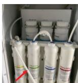
13. Gắn thêm 1 đoạn ống nhựa PE vào để cho nước chảy ra ngoài, rồi mở van cấp nước và cắm điện nguồn. Hãy để nước chảy ra liên tục khoảng 10 phút để xả bộ lọc.
